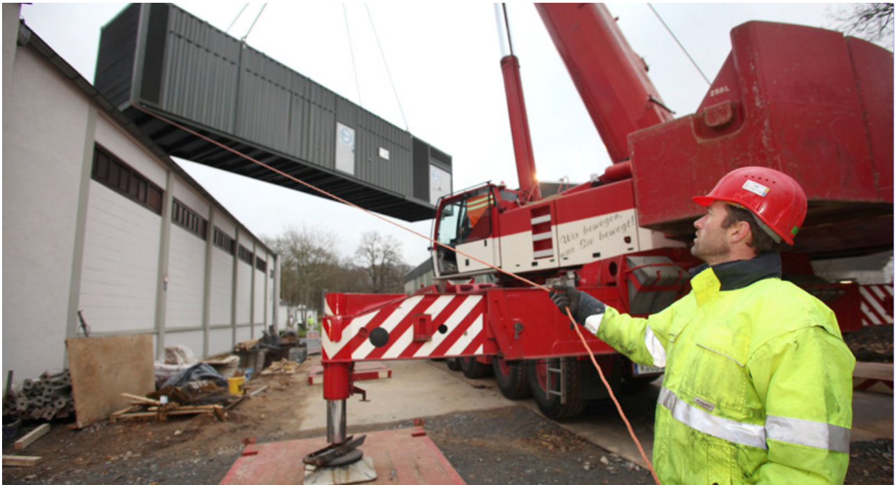
Einrichtung einer Notstromversorgung für ein Wasserwerk
