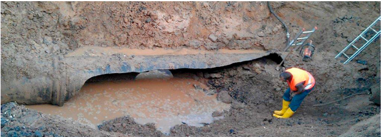
Rohrbruch, Wassertransportleitung DN 800
